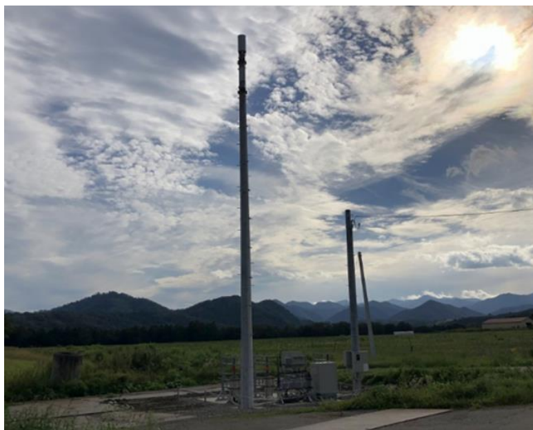
(写真) 北海道広尾郡のタワー（基地局搭載前）
