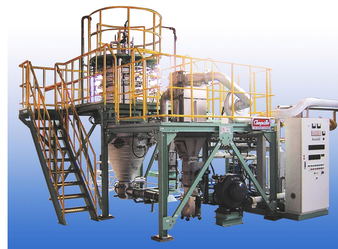
火炎内処理設備「INFLAZ®」
