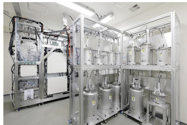
本体裏側タンクヤード 写真
