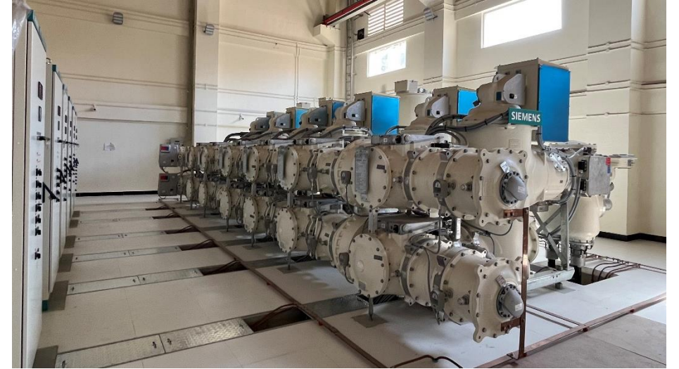
変電所建屋内
