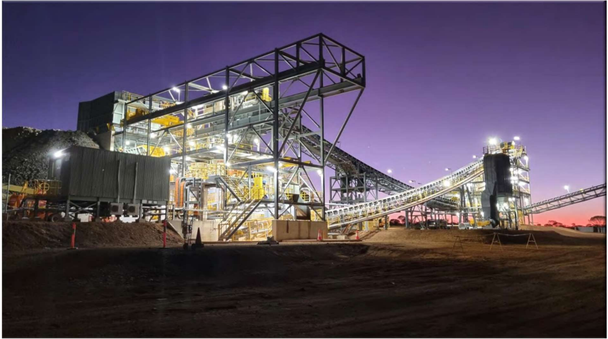
豪 Abra 鉛鋅山地上選鋅プラント粗鋅破碎工程(2022年11月11日時点)
