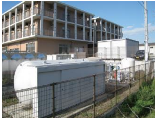
福祉施設（スプリンクラー設備）
