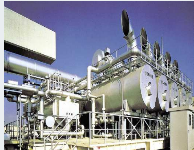
＜環境保全設備＞
