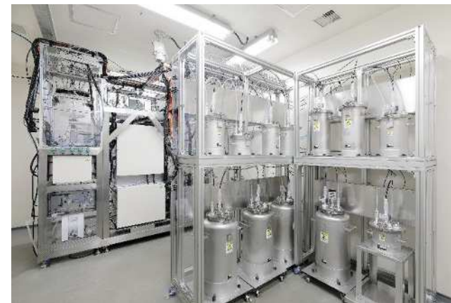
本体裏側タンクヤード 写真
