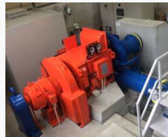
小型水力発電設備
