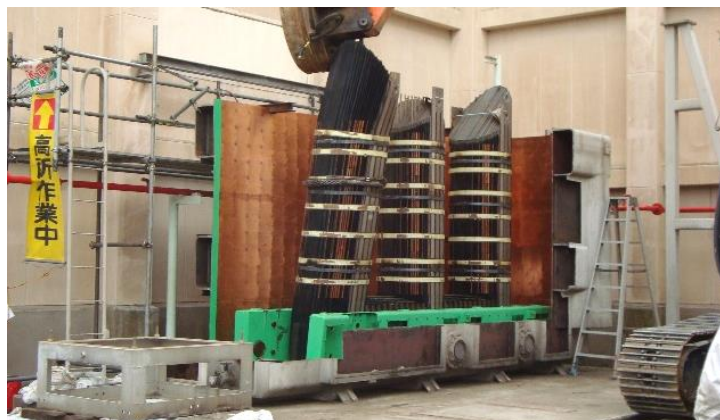
大型変圧器（トランス）
