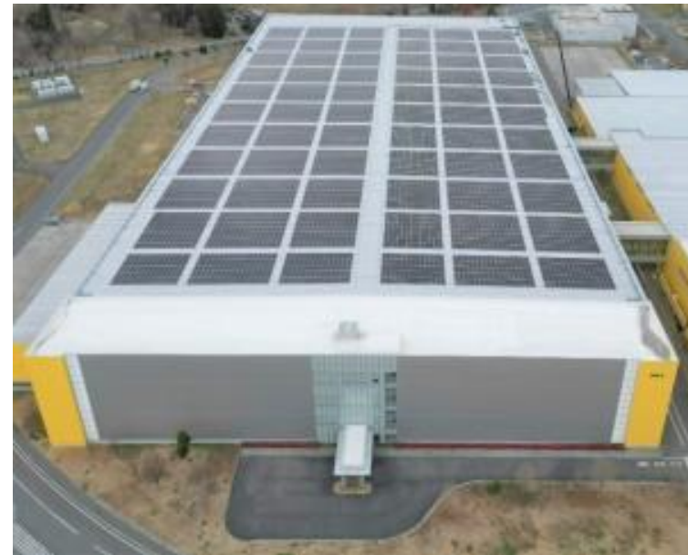
壬生工場（2.5MW）
