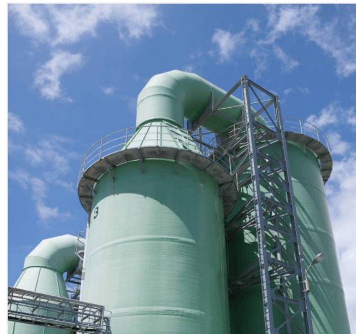
ヨウ素生産設備:ブローイングアウト塔
