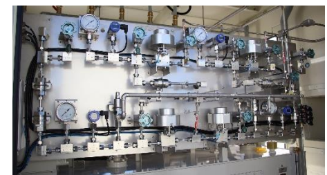
福島水素充填技術研究センターと センター内の水素圧縮装置
