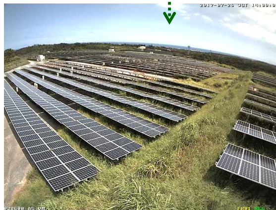
WEBカメラによる発電所の様子
