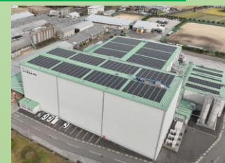
KSオークラ太陽光発電設備
