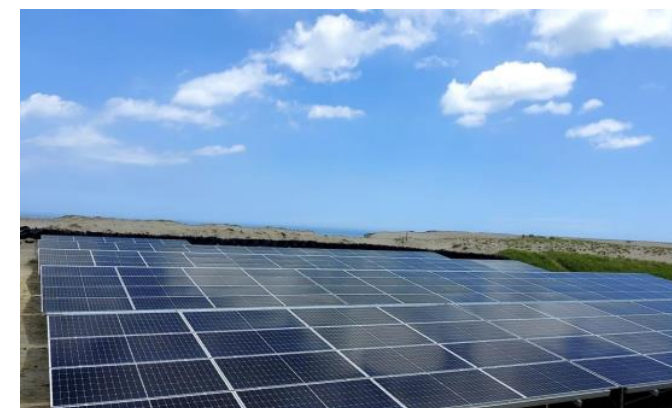
【WWB 神栖太陽光発電所】
