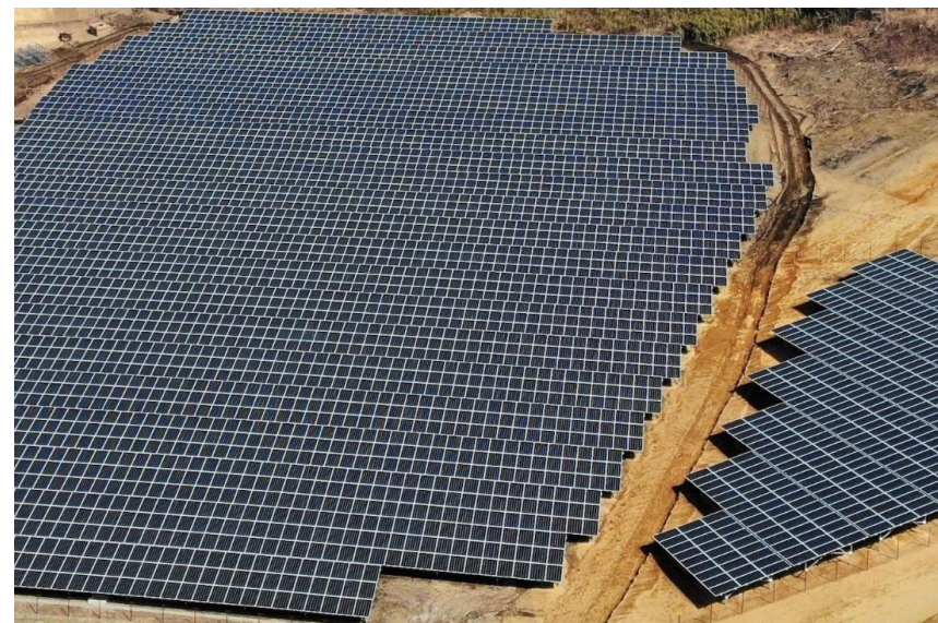
花畑太陽光発電所(群馬県)/(DC):約3.6MW
