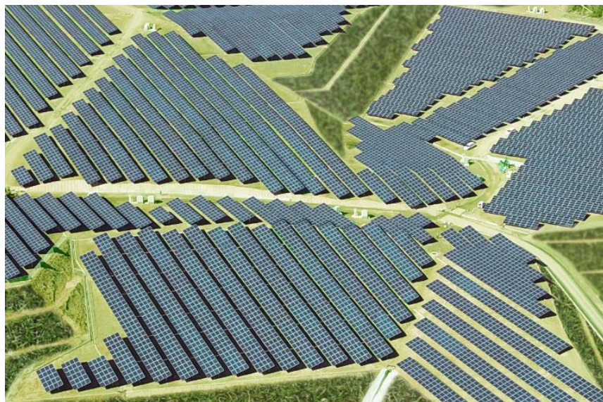
角田市太陽光発電所(宮城県)/(DC):約18.3MW
