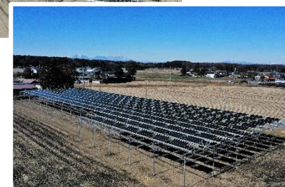
真岡市営農型発電所
