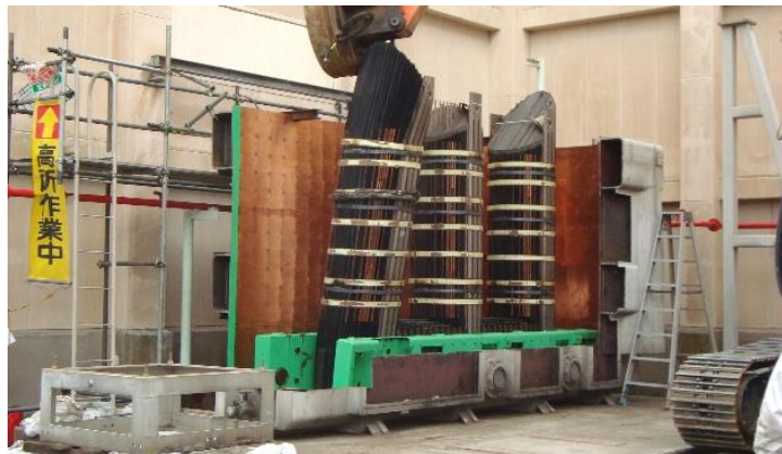
大型変圧器（トランス）
