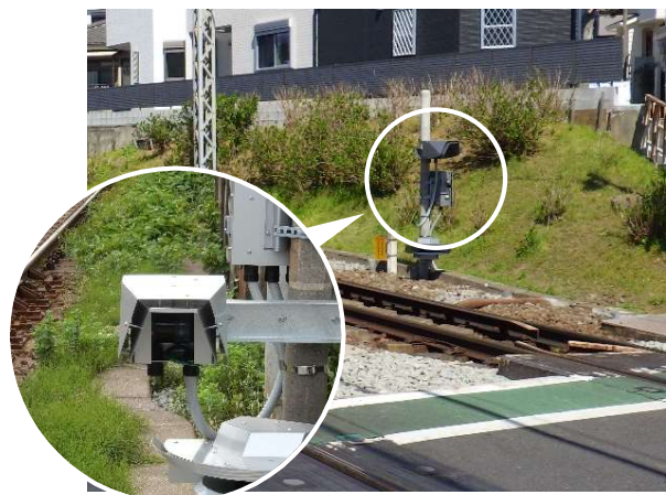
二次元式踏切障害物検知装置
