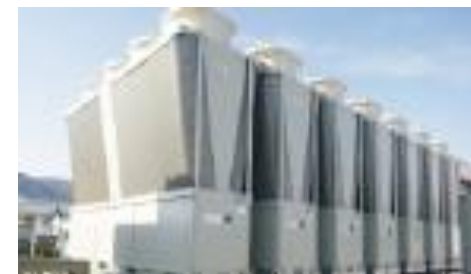
▲導入を進めている電気式空調設備
