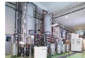
イオン交換樹脂再生設備
