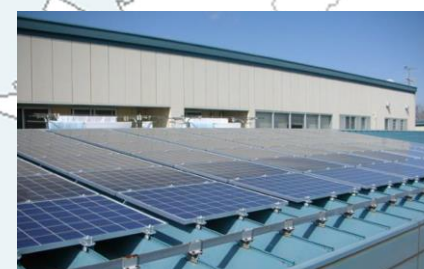
太陽光発電設備を設置し、 環境問題に貢献
