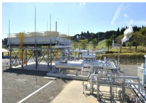
【メディアポリス指宿 地熱発電所】
