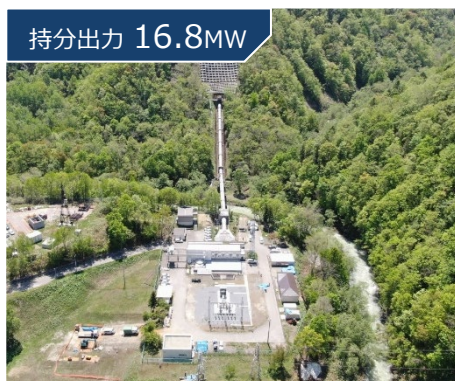
北海道 新桂沢発電所
