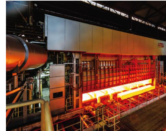
鉄鋼向け省エネ型厚板加熱炉
