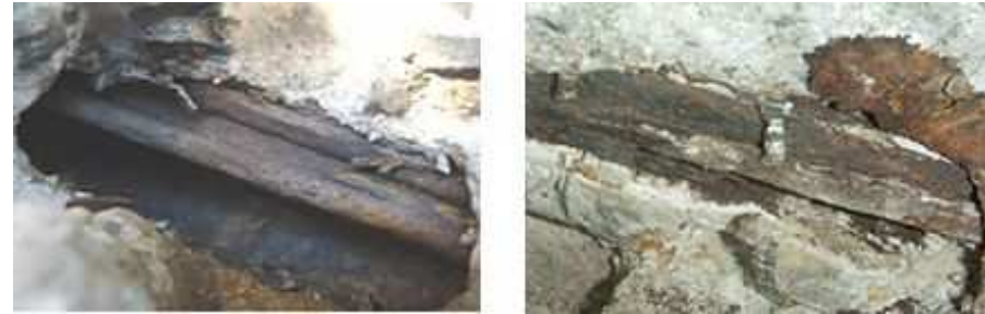
ポストテンションPCT桁橋の主ケーブルで確認された著しい鋼材腐食
