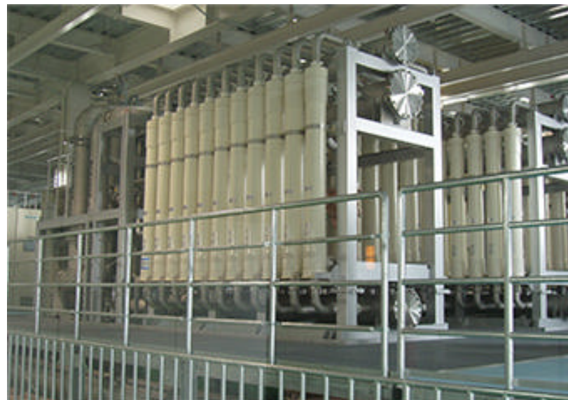
浄水施設(膜処理設備)の全景
