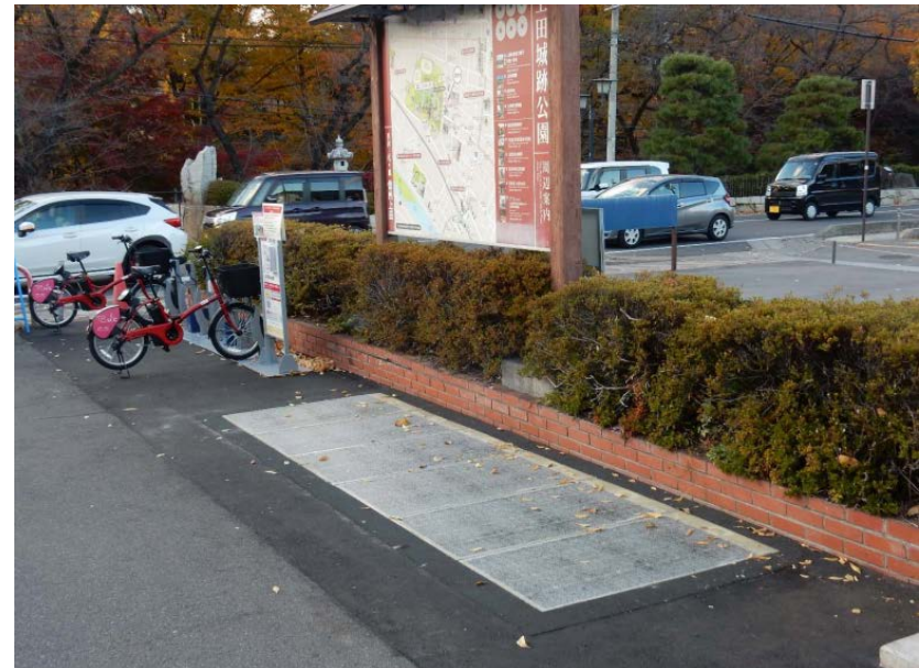
太陽光パネルで発電した電力で蓄電池を充電し、その電力を非接触充電対応のサイクルポートを通じて電動アシスト自転車のバッテリーに供給。路面に設置する太陽光パネルをシェアサイクルの充電に活用するのは全国初の試み。
