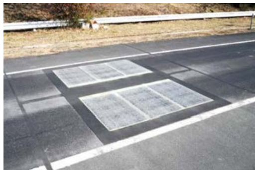
20万輪相当の荷重が通過後の状況
