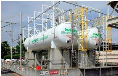
アンモニア設備
