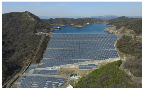
神谷ダム太陽光発電施設
