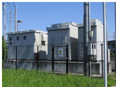
受変電設備の高上げ
