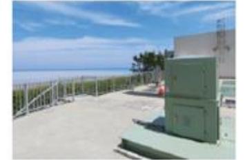
糸魚川市青海浄化センター (新潟県)
