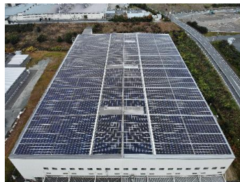
新城南工場の太陽光発電設備稼働
