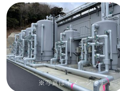
2026年4月以降 稼働予定 新規水処理施設
