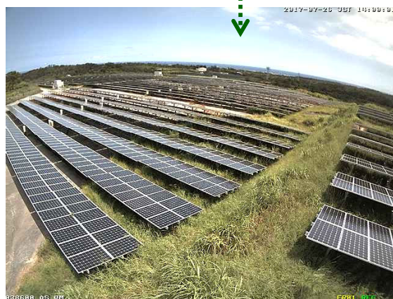
WEBカメラによる発電所の様子
