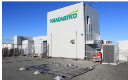
本社屋上の小規模実験設備
