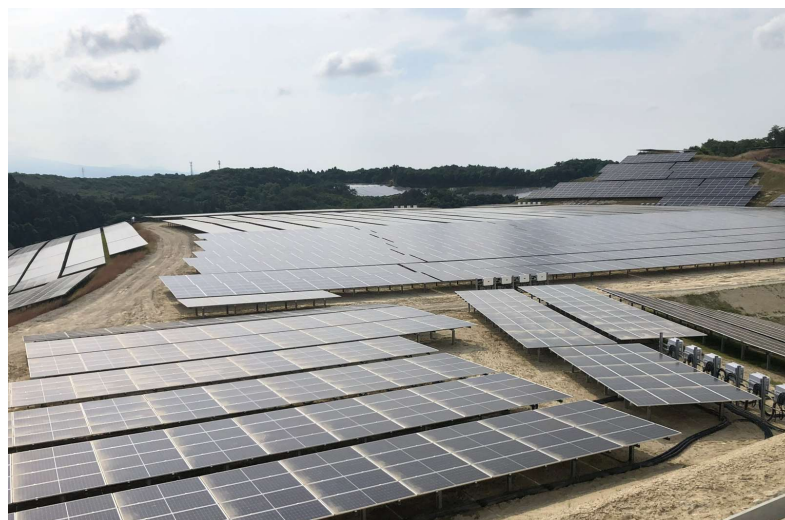
【大和町太陽光発電所】
