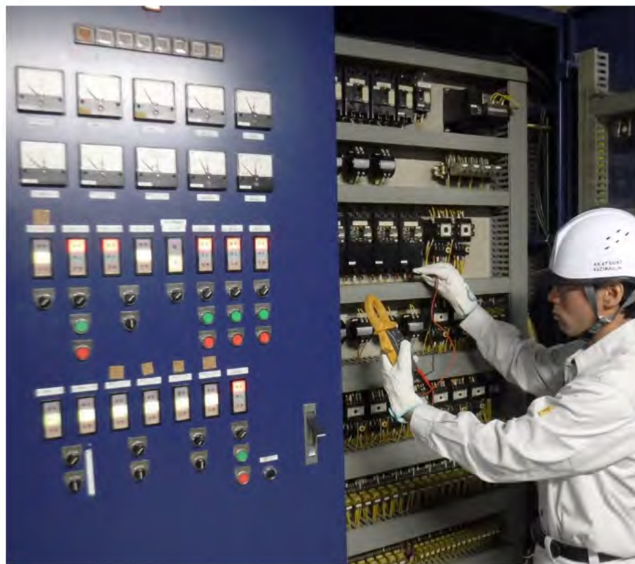
空調機制御盤点検
