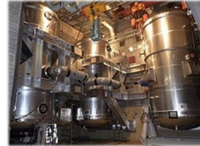
女川原子力発電所 原子炉格納容器フィルタベント系
