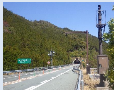
高速道路CCTV設備
