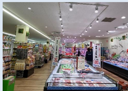
東武ストア蒲生店電気設備改修 (埼玉県)
