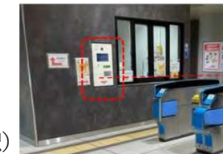
▶ 遠隔機能を備えた駅務機器（新綱島駅）
