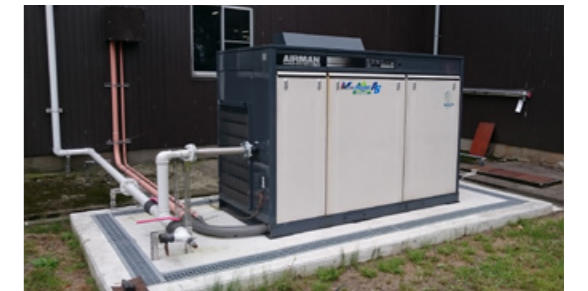
モータコンプレッサの稼働現場
