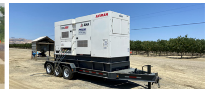
エンジン発電機の稼働現場
