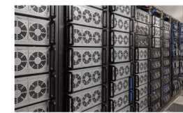
アメリカ・ワシントン州 第一データセンター
