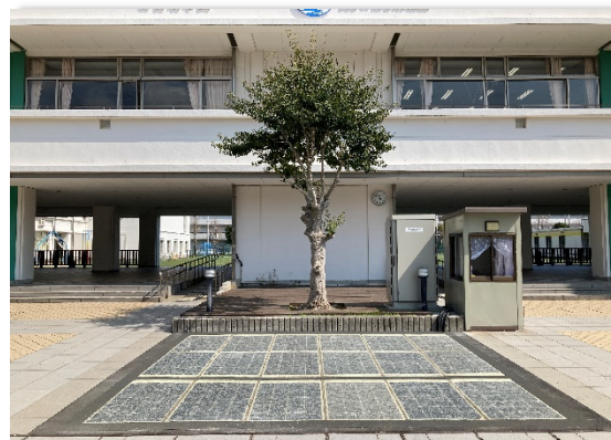
太陽光発電舗装Wattway (港区立お台場学園)
