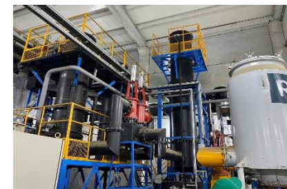
トルコ北西部ボル県、Goynuk（ゴイヌク）で 運転中のバイオマス・ガス化発電所
