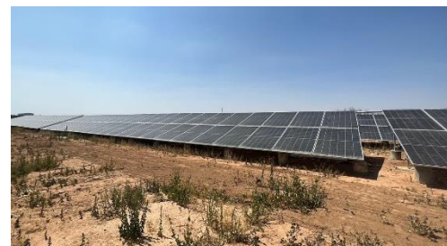
マフラク地区Sabha（ヨルダン）太陽光発電所
