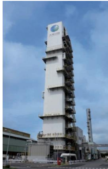
3号機（山口県周南市）
