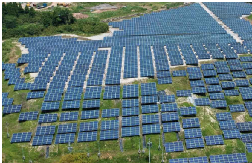
国東太陽光発電所
