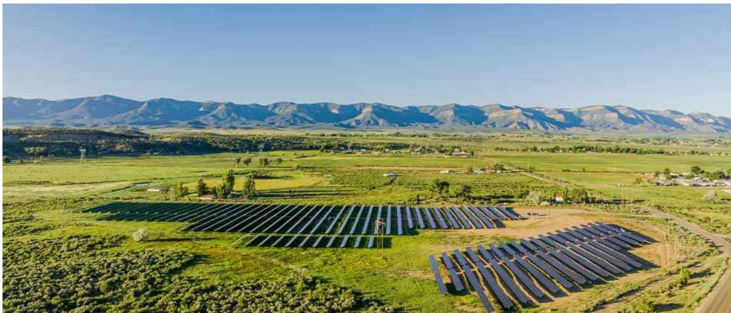
UtilityVSUN540 (Colorado, USA) ※VSUN社ホームページより
