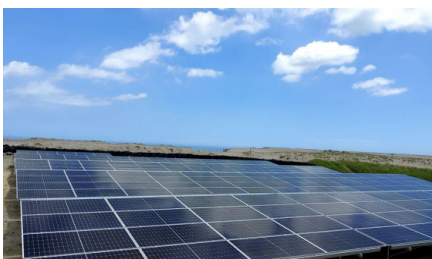
（神栖太陽光発電所）
