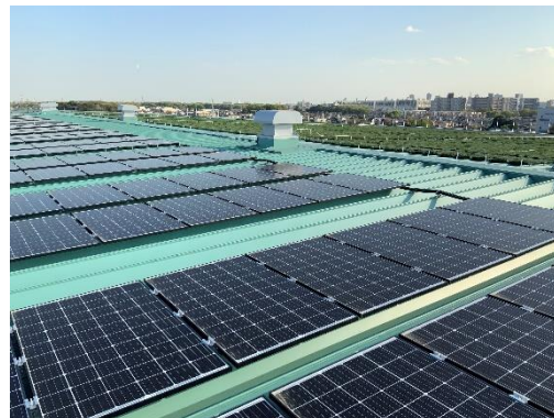
施設屋上設置型の太陽光発電パネル
