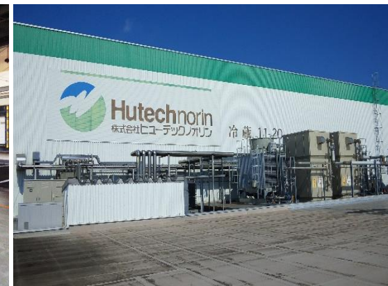
設置された自然冷媒機器
