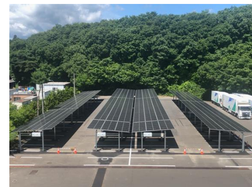
カーポート型の太陽光発電パネル
