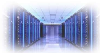
データセンター
