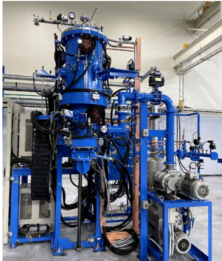
次世代電池素材熱処理炉
